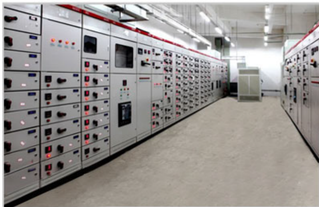
中低压配电柜
